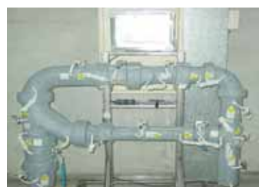
真空管路電熱布包及溫控
