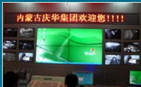
煤矿监控中心
