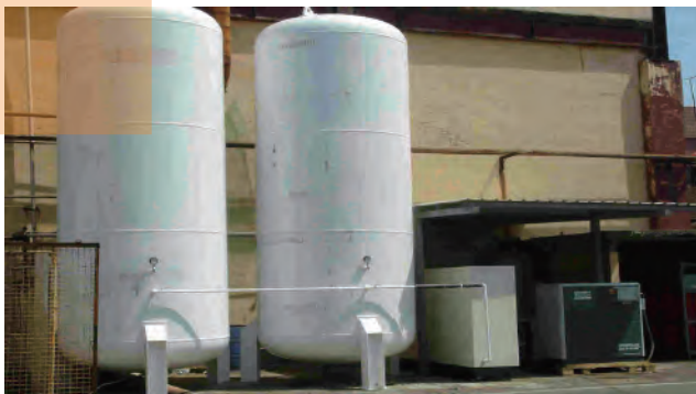
GRN60-3N(化工製程使用狀況)
